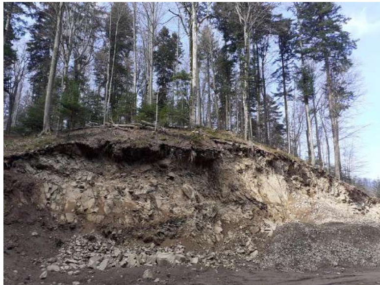
Foto nr. 2 Prăbușiri de roci în drum în Dealu Mare
